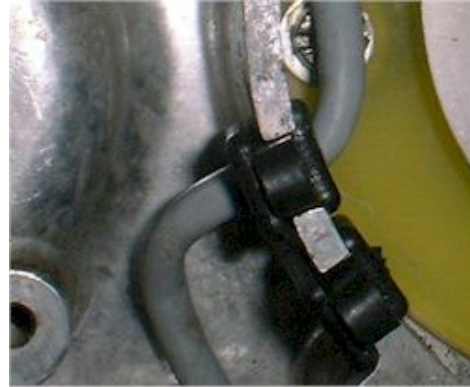
Abbildung 2 Das Anschlußkabel wird mit Hilfe der mitgelieferten Gummitülle durch das Motorgehäuse geleitet.
